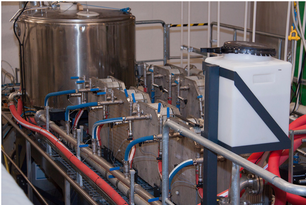
Vår anläggning på Hammarby Sjöstadsverk, FoU Kungliga Tekniska Högskolan (KTH) och Svenska Miljöinstitutet (IVL). Har testats med många olika föroreningar. I drift under drygt tio år utan reparationer och med mycket litet underhåll.
